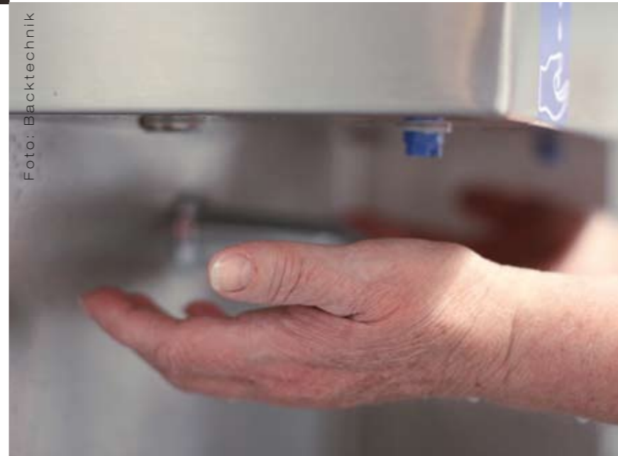
Zwei berührungslose Sensoren müssen aktiviert werden, damit die flüssige und nicht zu stark schäumende Seife auf die Hände gesprüht wird.
